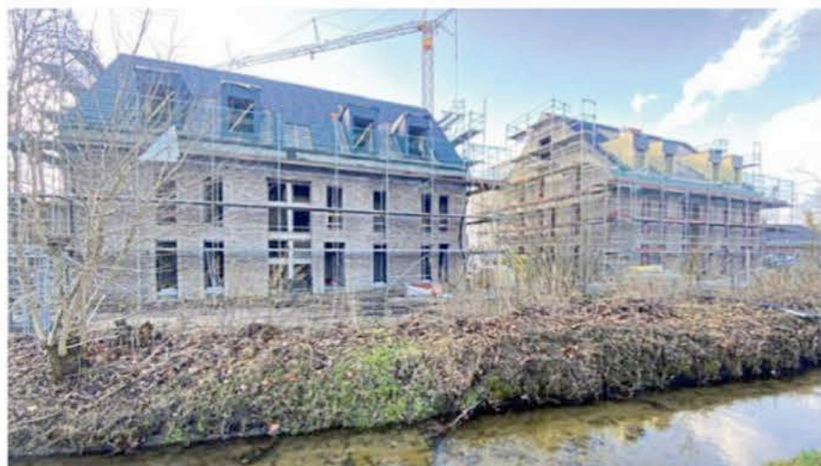
Zwischen dem Hilterweg und den Mehrfamilienhäusern fließt der Pulverbach. Eine neue Retentionsfläche soll Überschwemmungen vermeiden.
