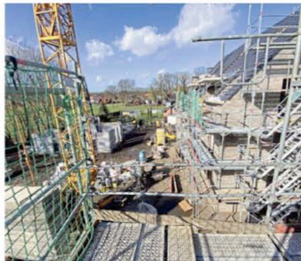
Blick vom Gerüst eines der drei Mehrfamilienhäuser auf die im Bau befindlichen Nachbargebäude.
